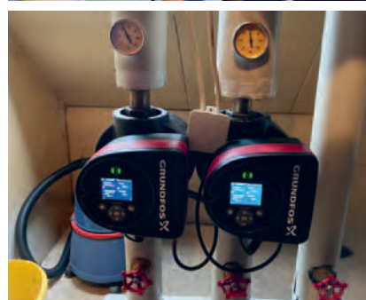
Alles eine Frage der Technik: Diese moderne Pumpentechnologie überwacht den Durchfluss an den Rohren der Heizungsanlage.
