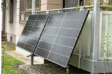
Am Balkon eines Mehrfamilienhauses im Westlichen Ringgebiet in Braunschweig sind Solar-Module für ein Balkonkraftwerk angebracht worden. STACHURA, FMN
